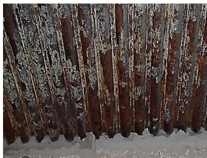
【既設のボイラ水管】
